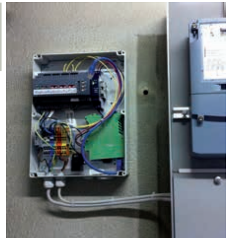
Blick unters Gehäuse der Datenzentral - in diesem Beispiel bei Inbetriebnahme als Spezialausführung mit Glasfaser Modem. Die Einheit wird direkt auf die Anlage geliefert und dort an die Wand montiert.
