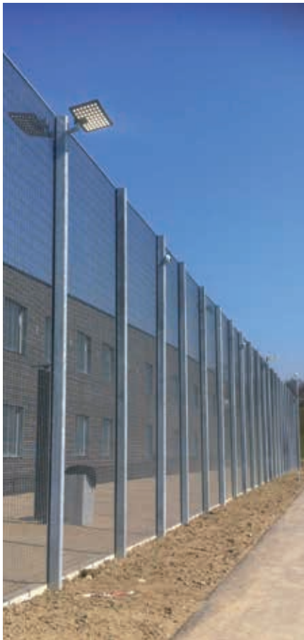
Auch Aussenleuchten in gebäudenahen Bereichen (wie hier in Palézieux) eignen sich bestens zur Vernetzung. Vorteil: keine zusätzliche Kabeleinzüge notwendig.
