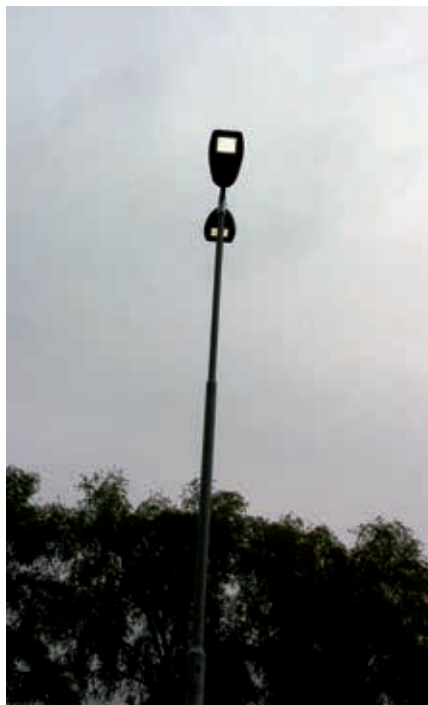
Strassenleuchten mit eingebautem Powerline-Aktor, Komponente (E) wie in Anlagen der Stadt Zug realisiert.
