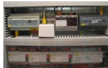
Eine echte Multivendoranlage: Komponenten von PentaControl, Infranet Partners (DALI-LON-Lamp Actuator), Loytec (LON-IP-Router) und Echelon (i-LON-Server) mit der Anschlussdose ans Netz. (Quelle: BUS-HOUSE).
