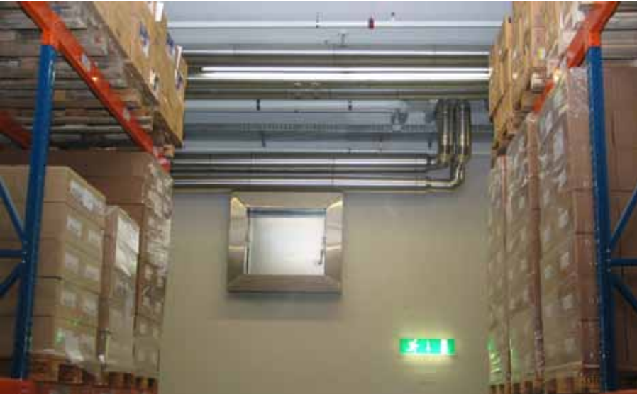
Rauchabzugsklappe im UG für die RWA, angesteuert von LON. (Quelle: BUS-HOUSE)
