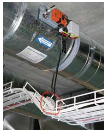
Erschliessung der Volumenstromregler mittels Woertz multibus Kabel
