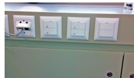
Bedienfelder Tt_Print am Brüstungskanal
