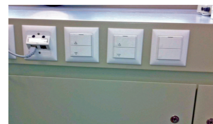
Bedienfelder Tt_Print am Brüstungskanal
