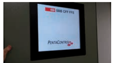
Lichtsteuerung für 3400 DALI-Leuchten, bedient mit Touchpanel LOYTEC L-VIS
